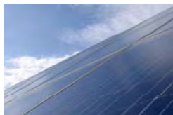
Quelle: www.liteco.ch / Solar-Photovoltaik-Anlage
