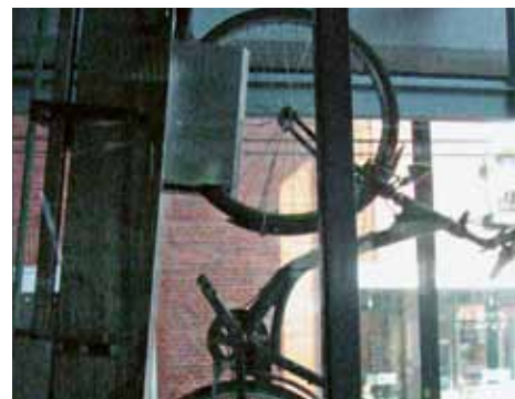
32-4.0 et 33-4.0 Installation de stationnement automatique
