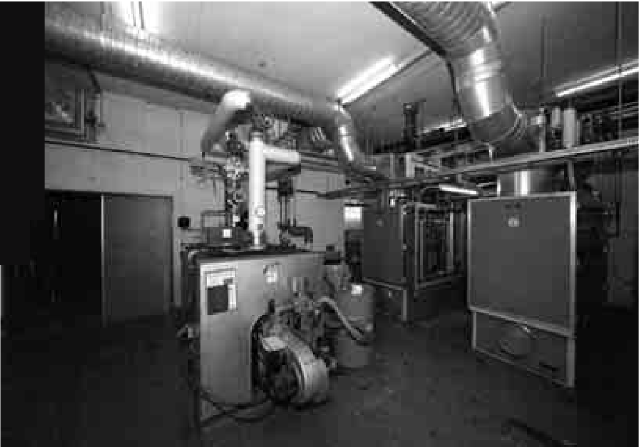
Blockheizkraftwerk, basierend auf Biogas aus der Kläranlage
